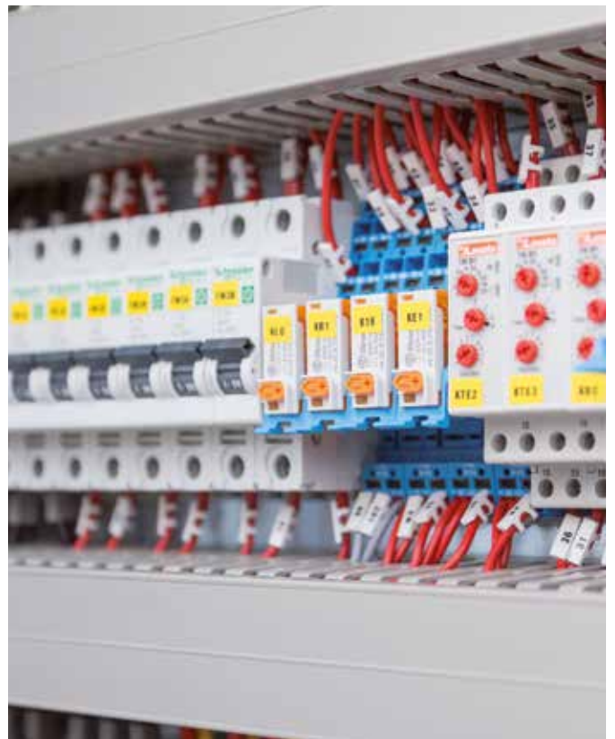
Logische en "nette" installatie in de schakelkast
